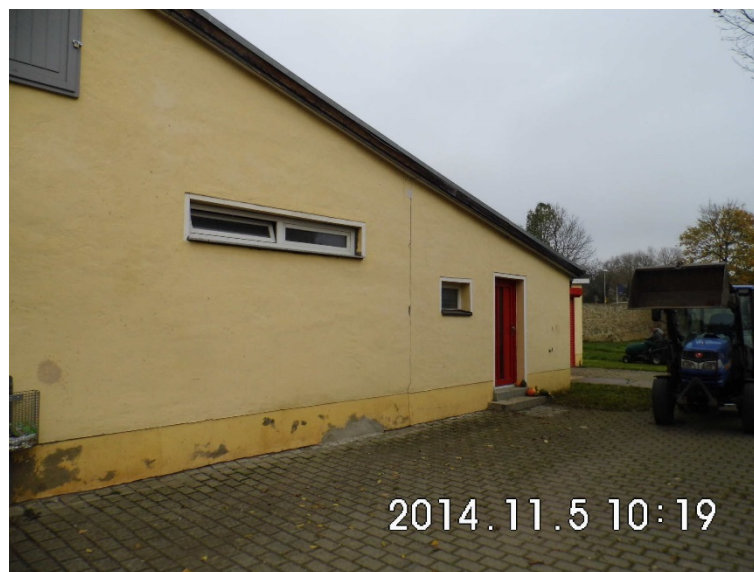
Bild 8 und 9 - Gründungsrisse im Feuerwehrhaus Freckleben
