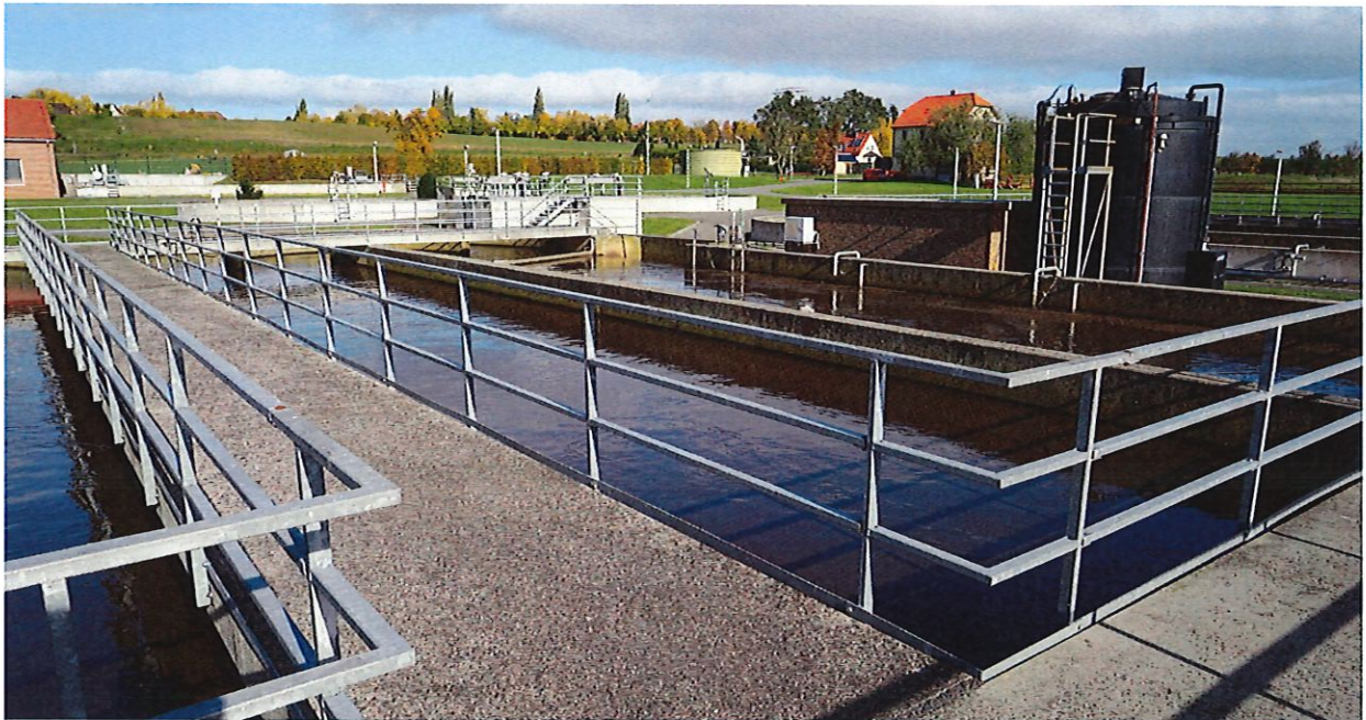
Belebungsbecken der Kläranlage Aschersleben – Biologische Reinigungsstufe
